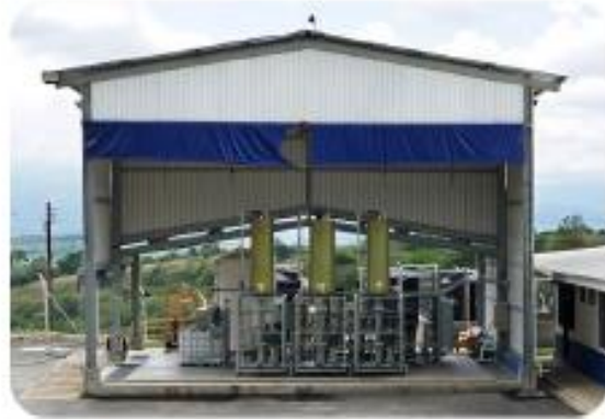
TRATAMIENTO DE LIXIVIADOS
