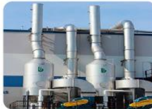
LAVADORES DE GASES
